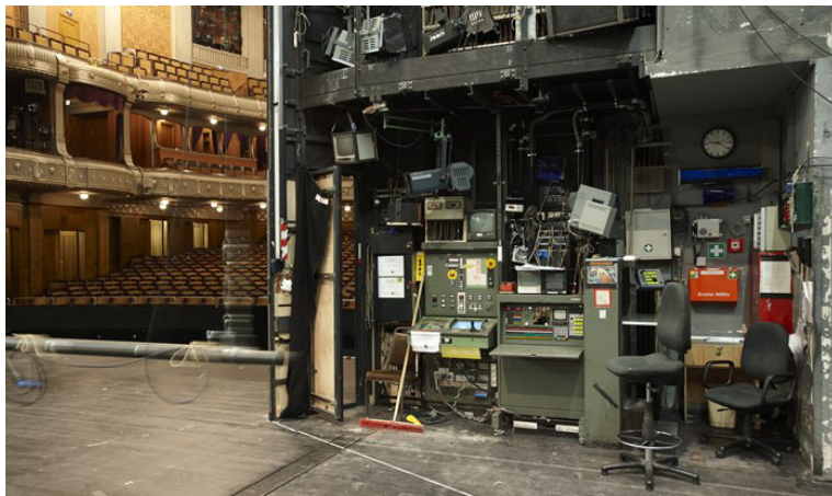
Blick auf die Steuerungsanlage der Bühnentechnik
